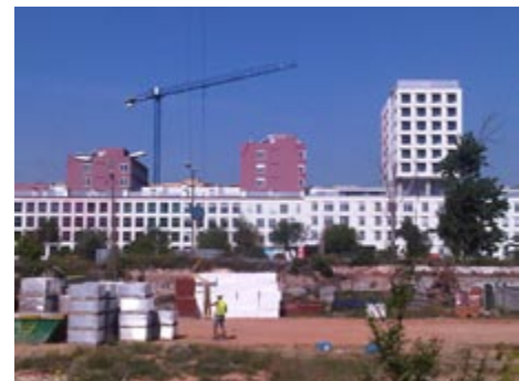
Nuevas viviendas sociales en los terrenos de los antiguos cuarteles de Sant Andreu, Barcelona 2011. Foto J. Barnada.
