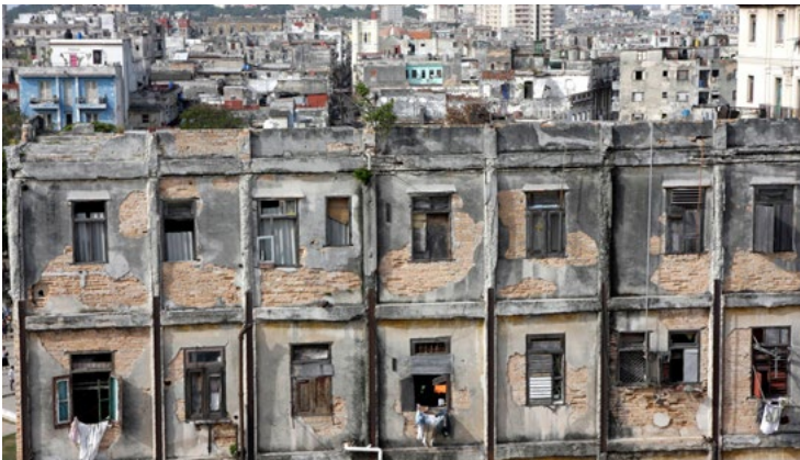
Figura 1. Edificio deteriorado, y habitado, detrás del Capitolio.
