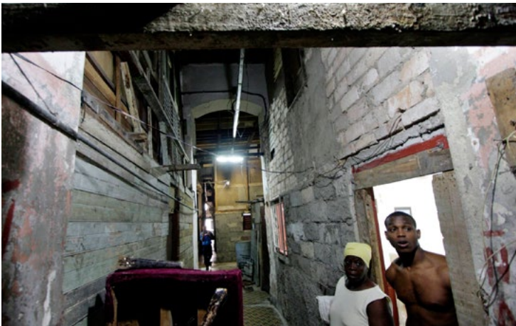
Figura 2. Vivienda dañada en La Habana.
