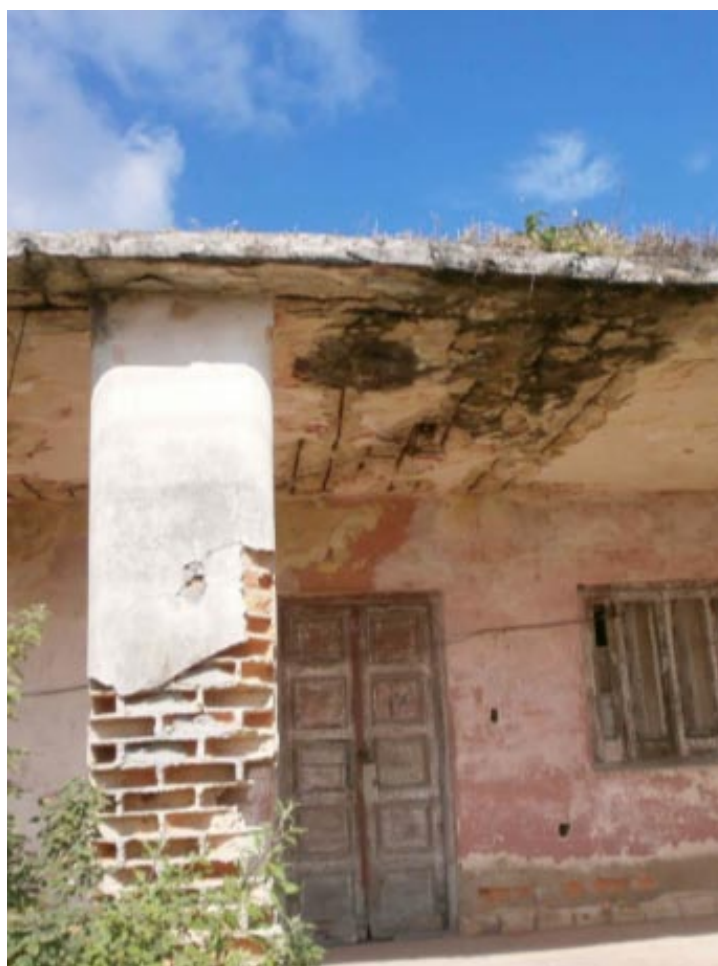
Figura 11. Lesión Deformaciones. Ave. 1ra No. 30402. Fuente: Autores.
