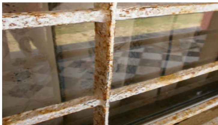
Figura 10. Lesión Corrosión. Ave. 1ra No. 30812. Fuente: Autores.
