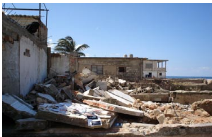
Figura 5. Derrumbes totales. Fuente: Tesis Diploma Grecia Chediak. Dirección Municipal de la Defensa Civil Playa.
