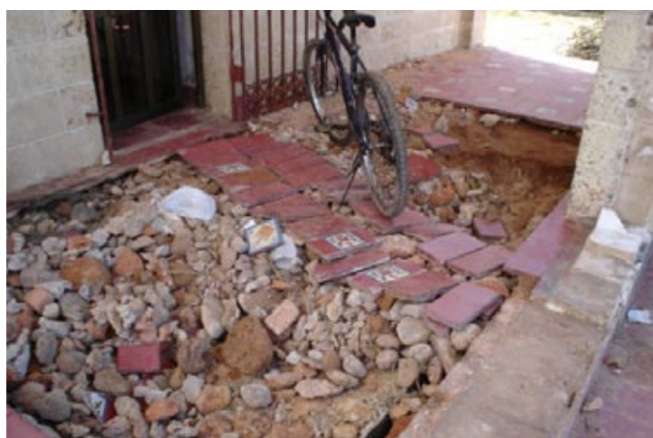
Figura 7. Desprendimientos. Fuente: Tesis Diploma Grecia Chediak. Dirección Municipal de la Defensa Civil Playa.
