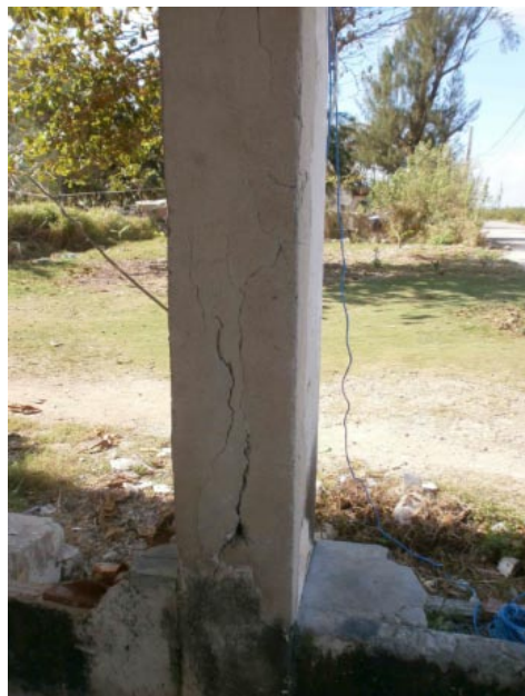
Figura 13. Lesión Fisuras. Ave. 1ra No. 30811. Fuente: Autores.
