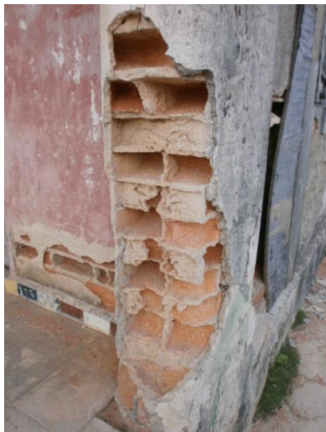
Figura 12. Lesión Erosión. Ave. 1ra No. 30402. Fuente: Autores.
