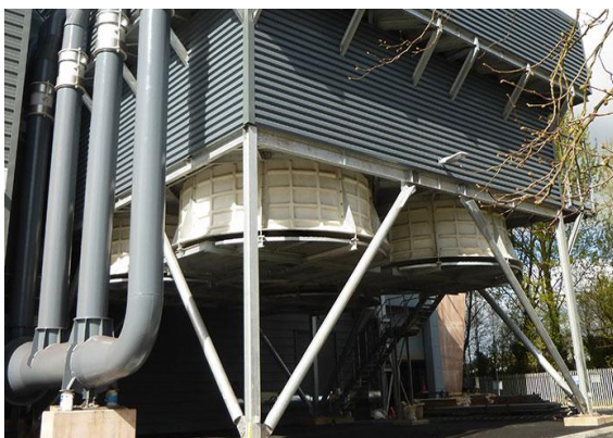
Figura 3. Condensador seco compacto (cuatro unidades de 10 MW cada una), instalado en una planta térmica de una fábrica de azúcar de remolacha en Marsella, Francia
