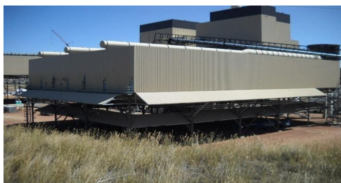
Figura 5. Condensador seco compacto (3 unidades de 8 MW cada una). En proceso de montaje (Ingenio Crystalsev2. Brasil)
