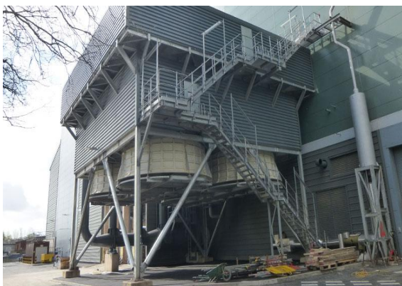
Figura 4. Condensador seco compacto (4 unidades de 12 MW cada una) instalado en el central azucarero. Crystalsev1, Brasil
