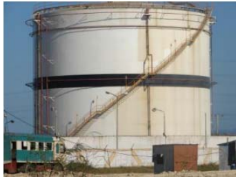
Figura 1. Tanque de almacenamiento de combustible.
