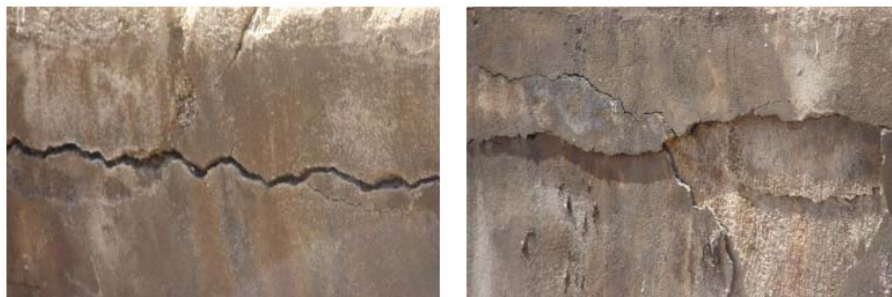
Figura 6. Grietas en la estructura (Acosta 2011).
