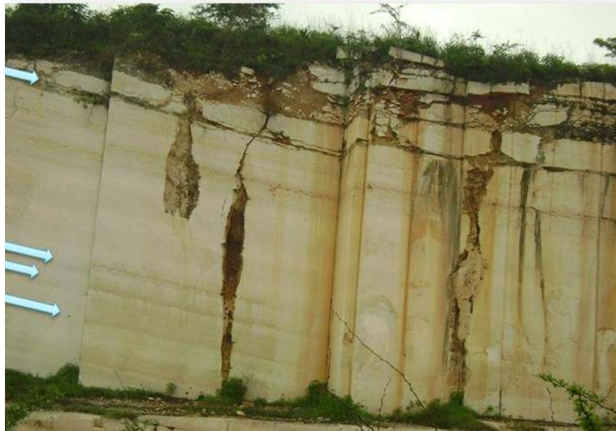
Figura 3. Grietas de estratificación.
