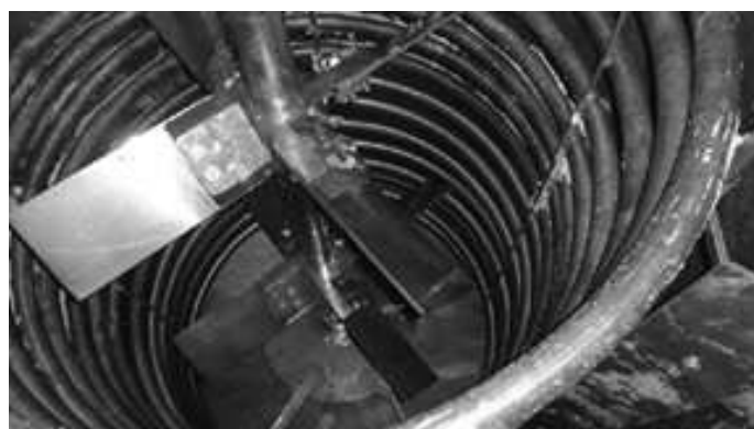
Figura 1. Serpentín donde ocurrió falla de codo.
