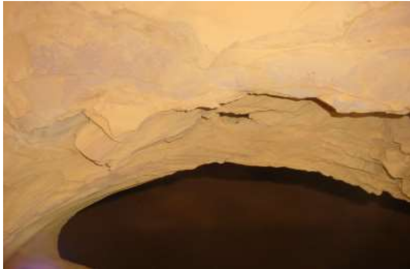
Figura 8. Material laterítico adherido a las paredes interiores del ducto que alimenta al separador de aire.
