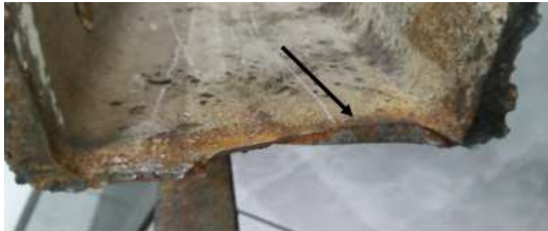
Figura 9. Desgarro del metal base en la zona del alma.
