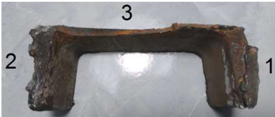
Figura 2. Zonas de la falla del perfil.
