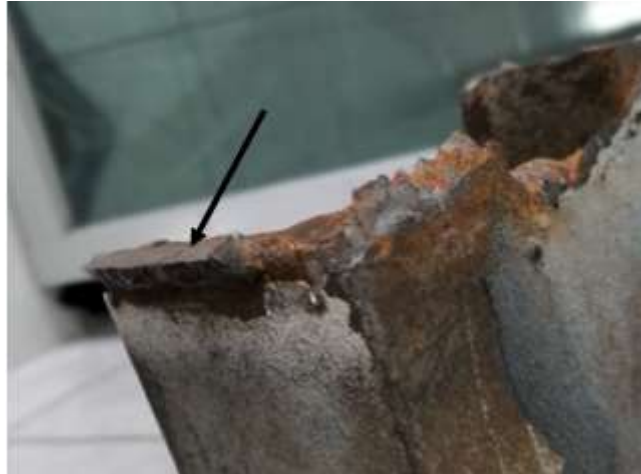
Figura 3. Zona del patín superior con falta de fusión.
