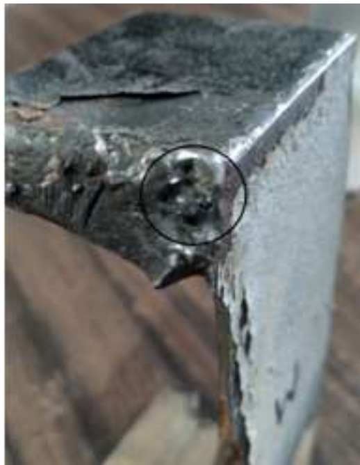
Figura 8. Porosidad agrupada en el metal depositado en el patín inferior.
