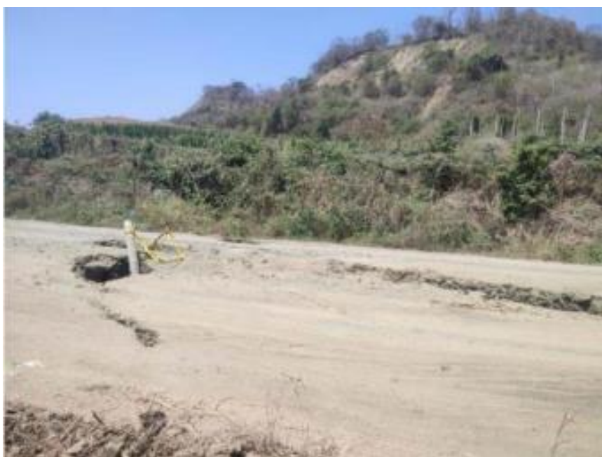
Figura 16. Correlación de los desplazamientos con los daños en la vía. (Fuente: elaboración propia).
