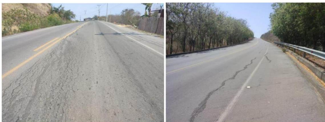
Figura 2. Grietas detectadas en la carretera a partir de la inspección visual (Fuente: elaboración propia).
