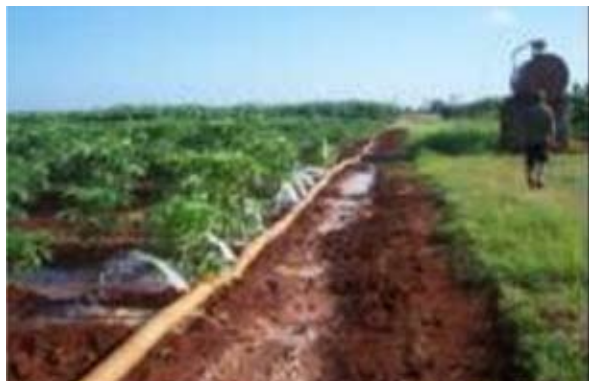
FIGURA 2. Tubería flexible con válvulas regulables.
