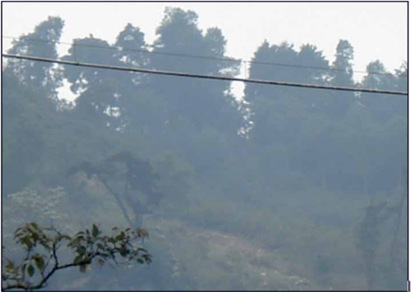
FIGURA 1. Paso aéreo en la comunidad de Sacapulas Altiplano occidental de Guatemala.(tomada por los autores).
