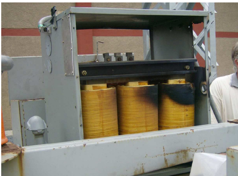
Fig. 3. Daño en el transformador elevador de 480/660 V.
