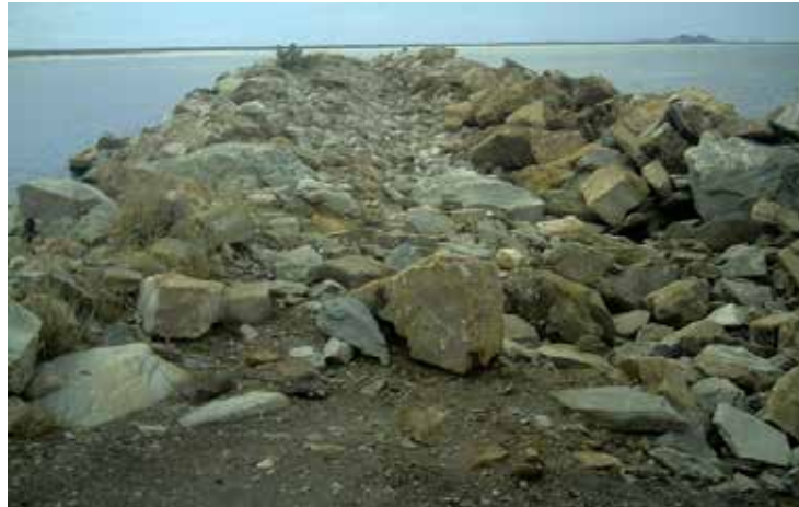
Figura 10. Sección dañada del Espigón 3. Tomado de Córdova y Torres (2009)
