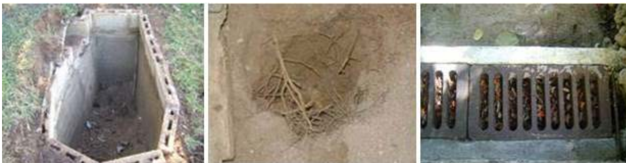
Figura 5. Evidencias de deficiencias técnicas y de mantenimiento de las obras de infiltración (Fuente: elaboración propia)
