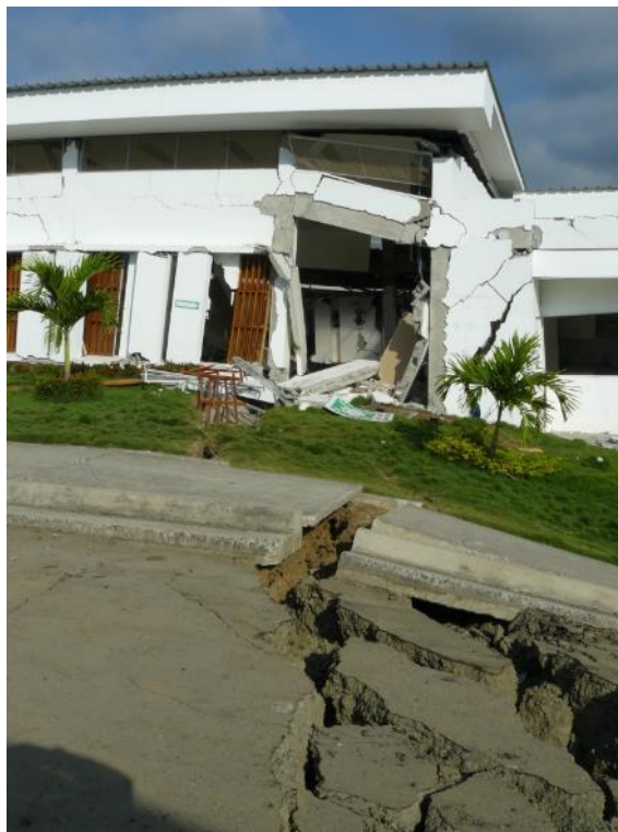
Figura 3. El nivel superior de las grietas paralelas se reactivó durante el terremoto del 16 de abril de 2016 elevando parte de la ciudad de Jama y dislocando varias casas (foto del autor)
