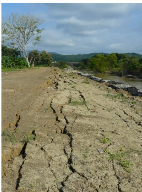
Figura 2. Sistema de grietas paralelas reactivadas durante el terremoto del 16 de abril de 2016 en el tercio inferior del río Jama, Manabí (foto del autor)
