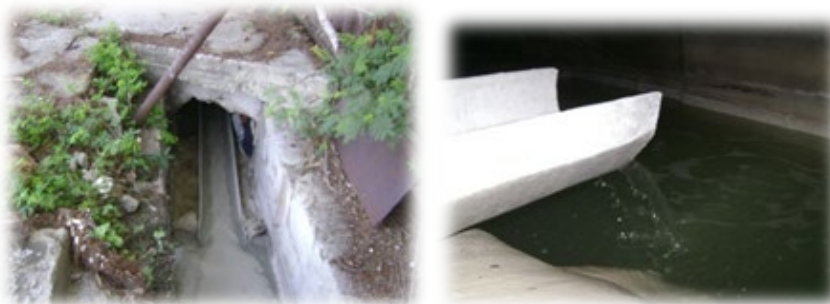
Figura 2. Punto final de vertimiento de Fibrocemento.
