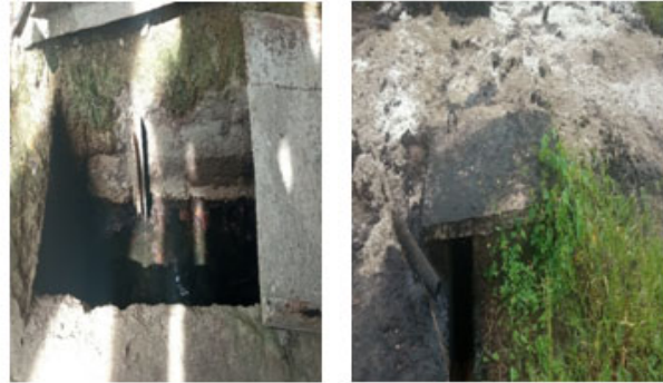
Fig. 12. - Estado actual del sistema de alcantarillado de la EEA
