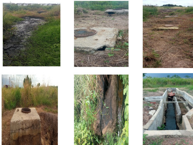
Fig. 13. - Estado actual del sistema de pre tratamiento de la EEA
