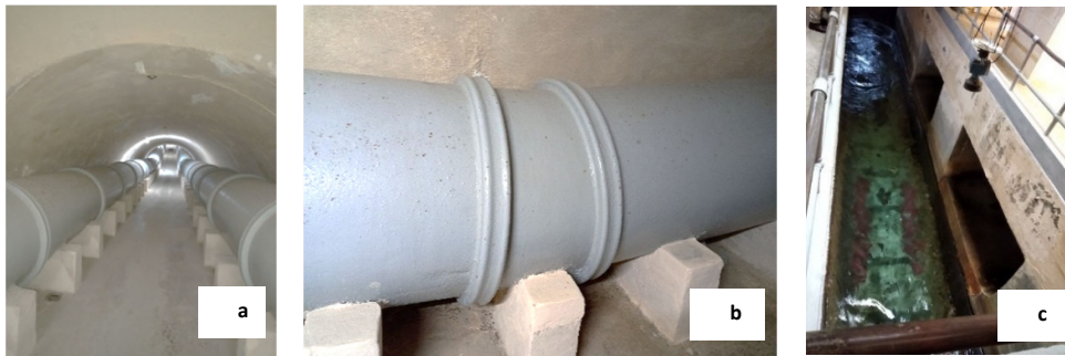
Figura 7. a) Sifones bajo el río Almendares, b) Detalle de inflexión y tipos de uniones, c) Vista del canal de sección abierta en Torre Norte donde se aprecia además el sensor de nivel existente y las galerías encargadas de la descarga de Taza Chica.
