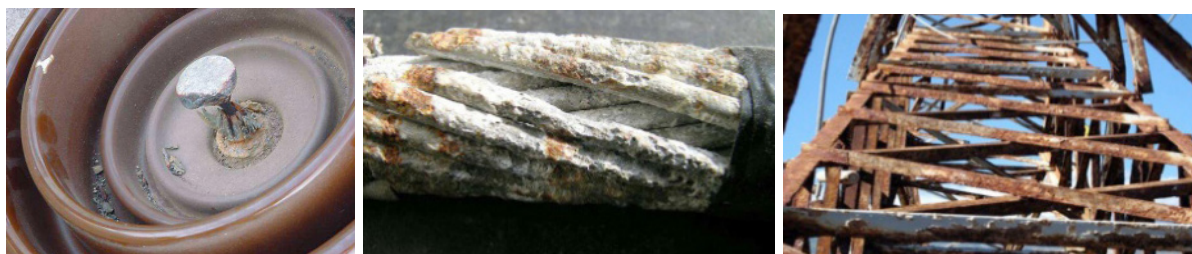
Figura 1. Corrosión en herrajes de aisladores, conductores y estructuras metálicas utilizados en los SEP. Fuente: Montes, 2016
