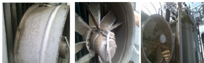
Figura 3. Deposición del polvo de las canteras en los ventiladores de los transformadores de potencia, dentro de la subestación. Fuente: elaboración propia. Foto tomada en enero de 2015
