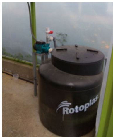
Figura 8. Sistema de bombeo de agua y tablero de control y temporizador. Fuente: Invernadero en funcionamiento
